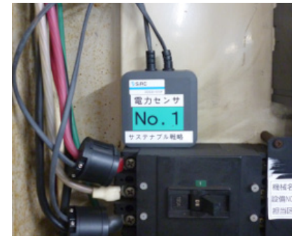
電力量の計測
