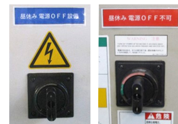
設備への昼休み電源 OFF 可能表示
